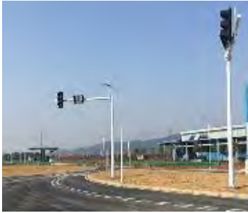
Signal System 道口信号系统
