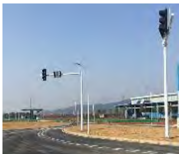
Signal System 道口信号系统
